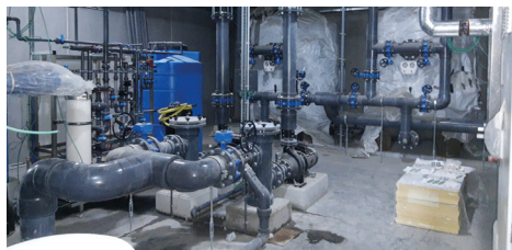
De installatie van de technieken van de sporthal en het zwembad is reeds vergevorderd.
