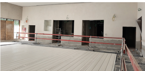
De betegeling van het zwembad werd afgewerkt en de dubbele beweegbare bodem in het zwembad werd geïnstalleerd. Het zwembad wordt gevuld voor het testdraaien van de technieken.
