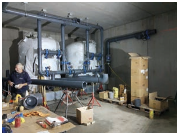
In het gebouw zijn leidingen gelegd evenals voorzieningen voor elektriciteit, lucht- en waterbehandeling in de zone van het zwembad, de kelder, de kleedkamers en de administratieve ruimtes.
