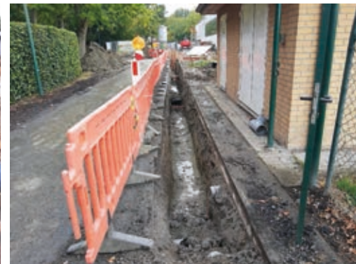
In oktober zijn de nutsvoorzieningen in de Hernieuwenstraat aangelegd. Het betreft hier de leidingen voor gas, elektriciteit, internet (glasvezel) en water.
